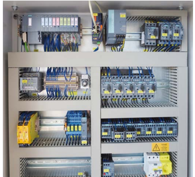
Einblick in die Steuerung
